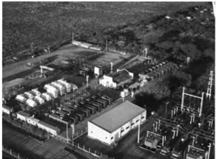
Empresas privadas participaron en el proyecto de construcción y operación de usinas termoeléctricas de Enarsa. Las nuevas usinas aportaron energía al Sistema Interconectado Nacional (SIN). En la imagen, la subestación Charata, en la provincia de Chaco, inaugurada en 2008.
